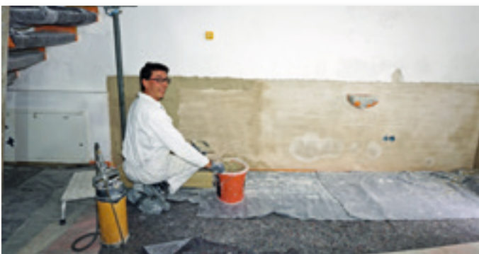
Mehrere Flächen im Sockelbereich müssen neu verputzt werden.
