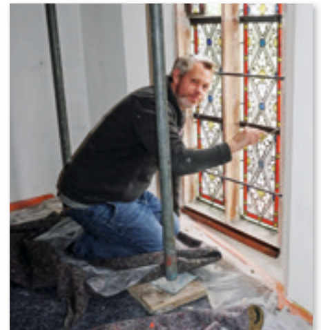
Die Abdichtung der Fenster muss in Feinarbeit nachgebessert werden
